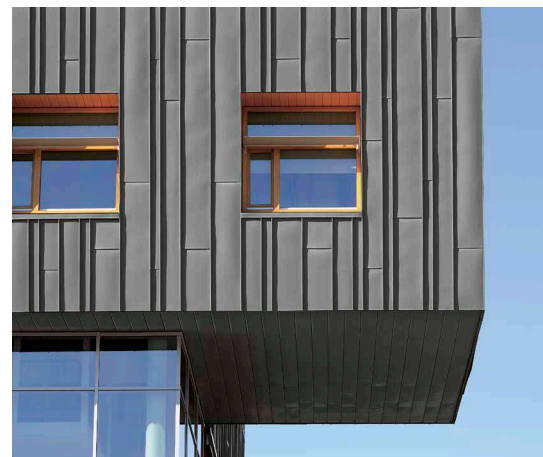
Auf der Unterseite kamen Steckfalzpaneele zum Einsatz, an den Fassaden die Winkelstehfalztechnik.
